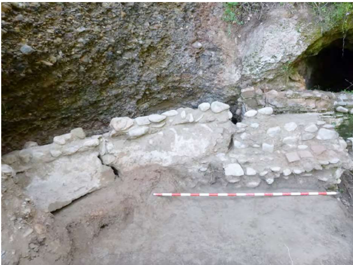
Fig. 9. Restos de la ampliación construida para la principal reparación de la estructura del partidor en el Barranco del Aljibe de la Lluvia.
