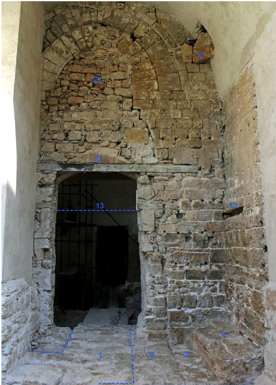
Fig. 30. Palermo, Cuba Soprana. Frente sur. Espacio 5. Muro de sillería perteneciente a la fachada del edificio fundacional (1). El nº 2 y 3 corresponden a la ampliación árabe de la fase II. El 4 es un banco del siglo XVI, retallado en la fábrica de sillería de la fase II. El 23 es la puerta de acceso al pabellón normando (Fase III) y el 13 indica la cota a la que se encontraba el pavimento de la plataforma (foto LAAC, EEA, CSIC).
